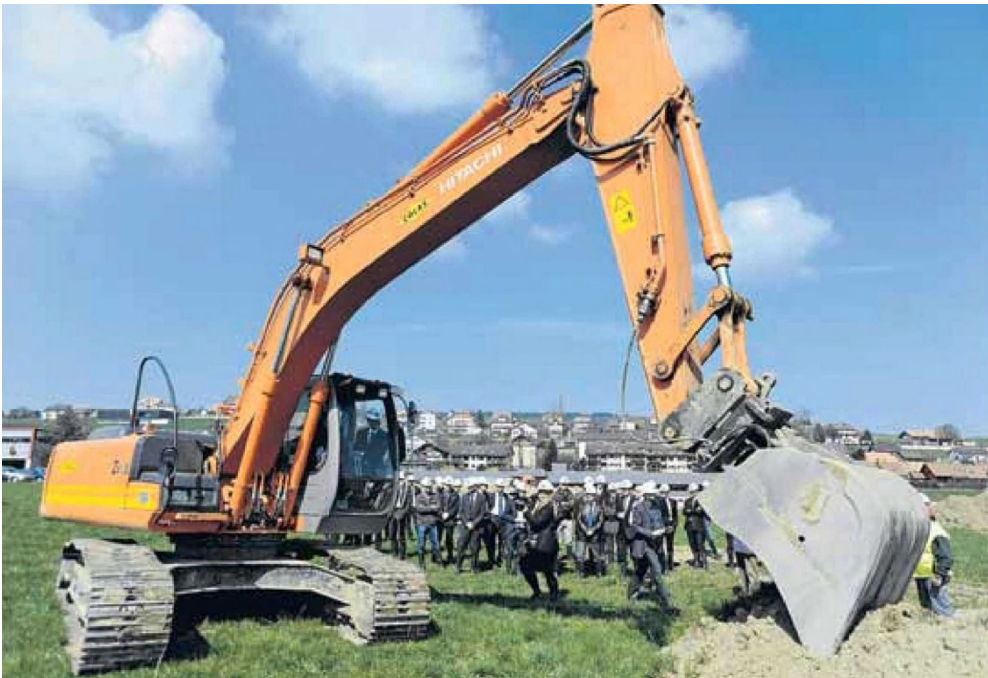
Spatenstich einmal anders: Die CPA Group AG fährt für den Baubeginn ihres neuen Gebäudes schweres Geschütz auf.
